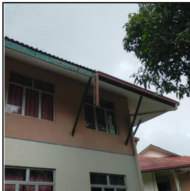
Rajah 2. Keadaan Gutter Yang Rosak Di Bangunan Kolej Kediaman UMS
